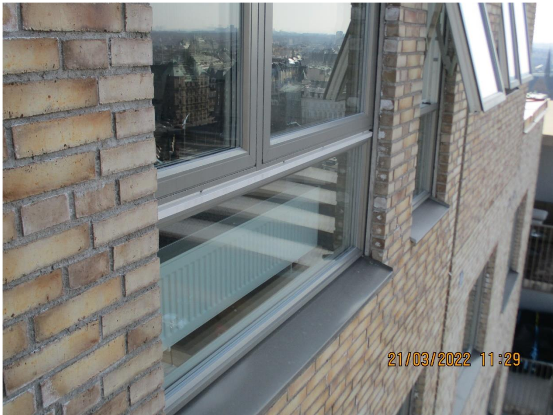
Plåtlist saknas på fönstermodul (horisontell)
