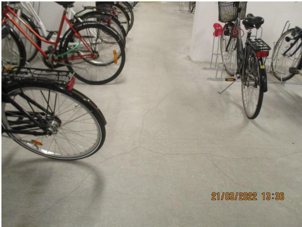
Sprickor i betonggolv.
