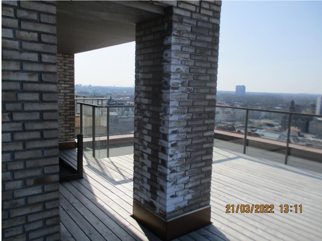
Utfällningar på tegelpelare.
