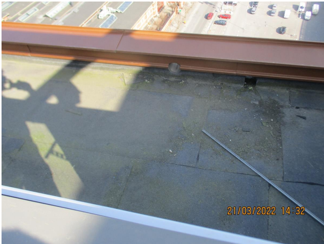
Stående vatten vid utlopp/avrinning på takterrass.
