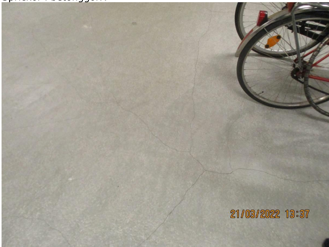
Sprickor i betonggolv.
