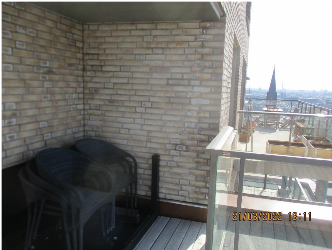
Utfällningar på tegel.
