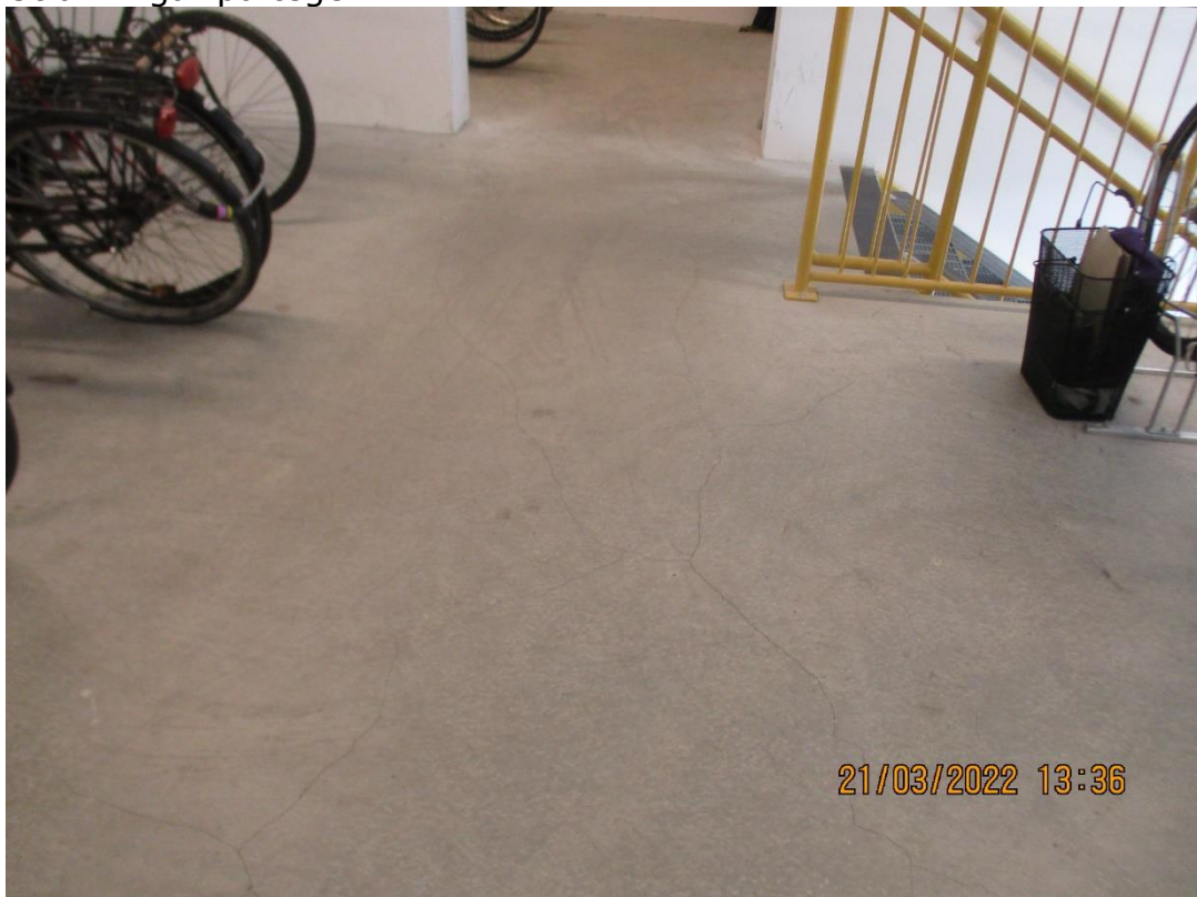
Sprickor i betonggolv.
